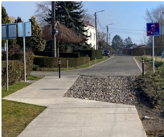
Ecluse à Bonine (SAS un peu court et dévoiement du cheminement cyclable trop sévère)
